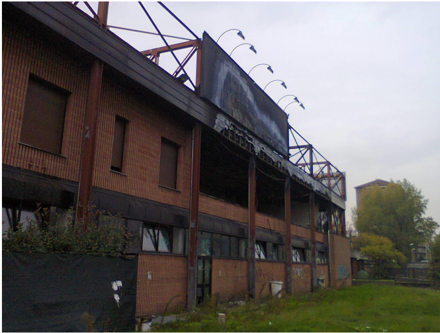
Fig. 3 – Prospetto Nord-Est (area oggetto incendio)
