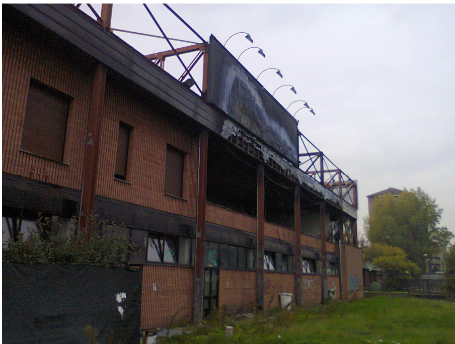
Fig. 3 – Prospetto Nord-Est (area oggetto incendio)
