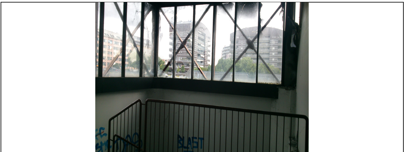
Fotografia 16 - zona scale di emergenza – esempio vetri da sostituire
