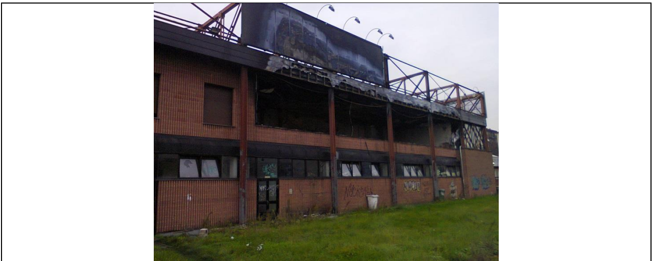
Fotografia 2 - Prospetto Nord-Est – area oggetto di incendio
