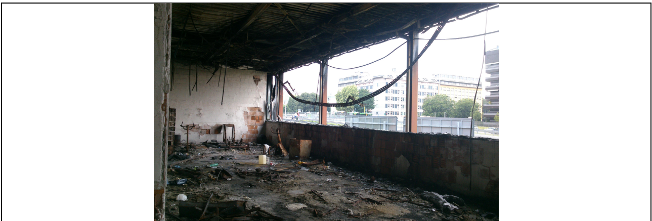
Fotografia 10 – Area oggetto di incendio
