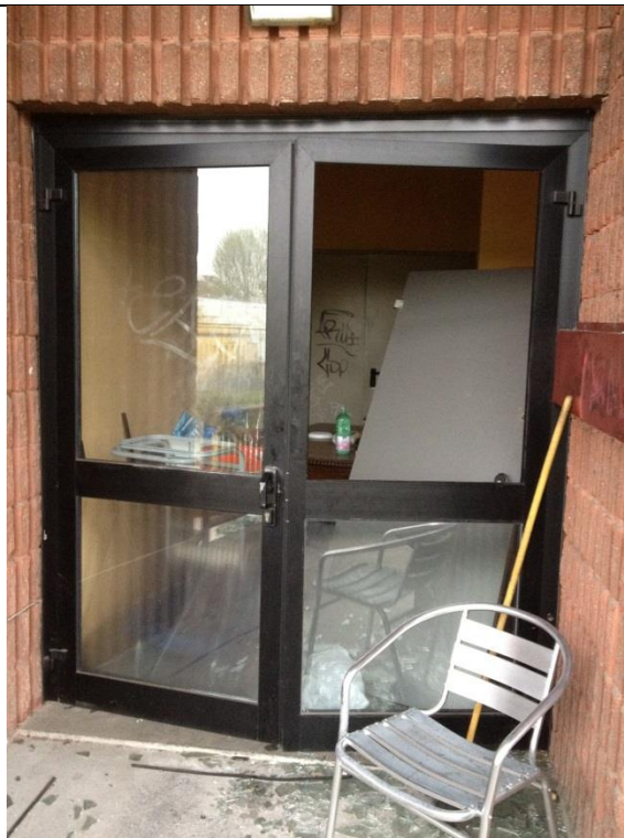
Fotografia 5 - Via di fuga da ripristinare
